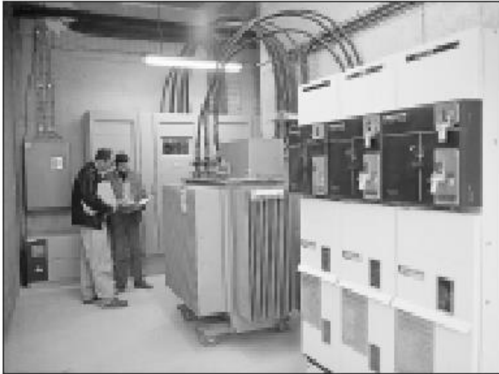
Fig 1-8 Poste avec cellules MT au premier plan et transformateur à l'arrière.
