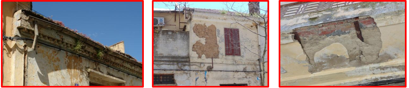
Figure 116 : quelque symptômes du la façade urbaine.
