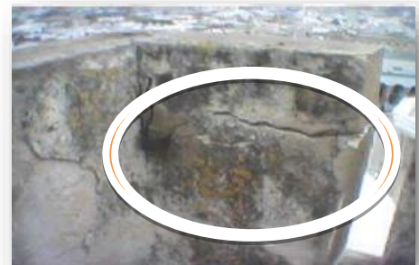
Figure 4:Fissure au niveau des acrotères
