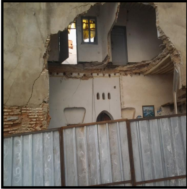
Figure 58 : bâtiment dans un état de ruine
