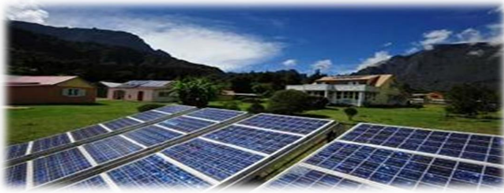
Figure 4 : les panneaux photovoltaïques. source : Google image
