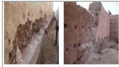
Figure 100 La muraille avant la Restauration
