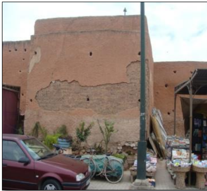
Figure . 99, La muraille avant la Restauration
