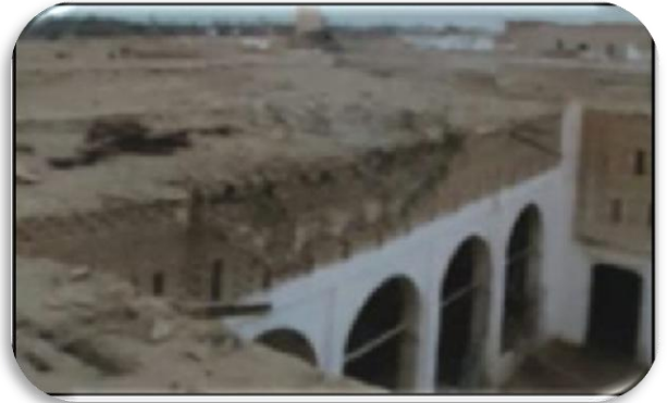
Figure IV-4 ; Etat des lieux de dar El Wadi avant la restauration
