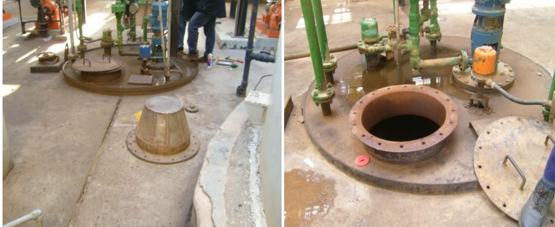
Figure II.5: Absence du filtre dans le puisard
