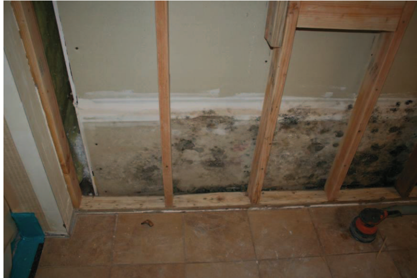
(d) Formation de moisissure sur le mur d'un local mal aéré
