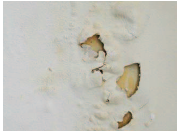
(c) Effritement de l'enduit suite à l'infiltration de pluie
