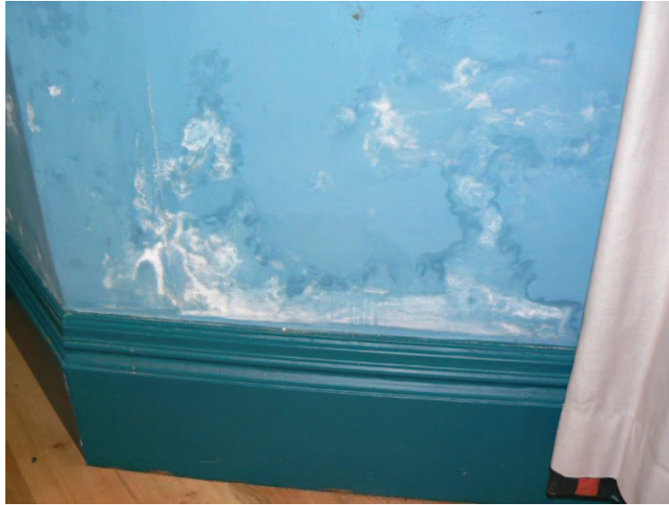
(a) Remontées d'humidité avec efflorescence de sel
