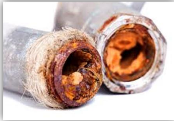
Figure 17: La corrosion des métaux [32].
