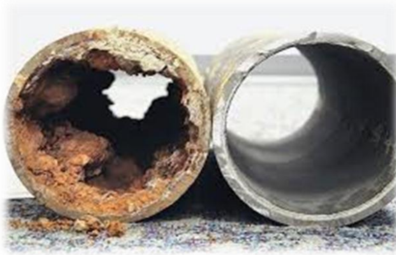
Figure 15: Détartrage d'une canalisation [29].
