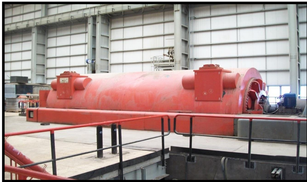
Figure (I-14) : Vue externe de l'alternateur de la centrale de Marsat El hadjadj
