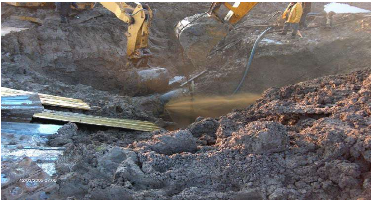
Figure III.1: Dégâts causés par les fuites des hydrocarbures des pipelines.
