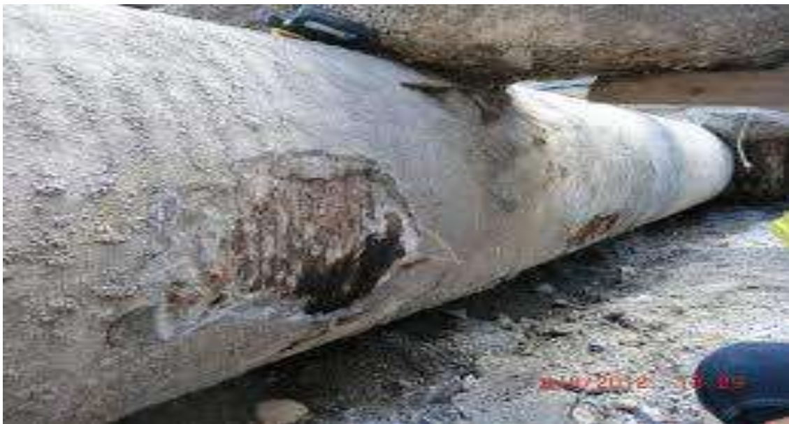
Figure I.4: Pertes de métal dues à la corrosion externe.
