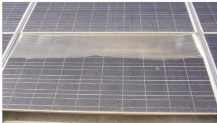
Figure. II.6: Défaut de délaminage.
