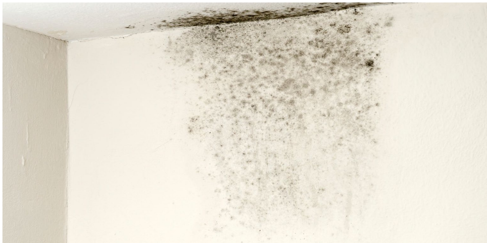
Figure 40 : un mur moisi à cause l'humidité à London, source (site web info sinistar )
