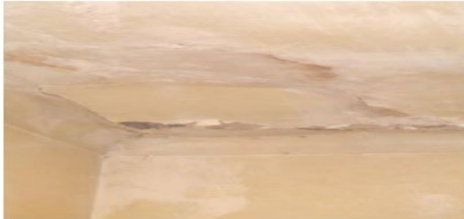
Figure 41 : Infiltration directe par le toit source (site web info sinistar)
