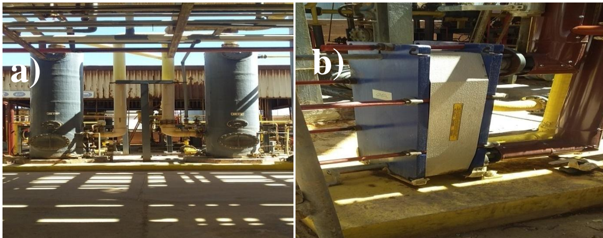
Figure II.15 : (a)Sécheur C-161 et C-162, (b) Echangeur de chaleur HE-161.
