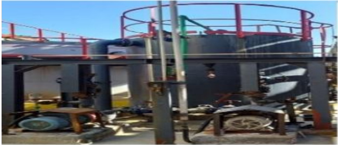
Figure II.9 : Bac de stockage T-110 avec deux pompes P-110A et P-110B.
