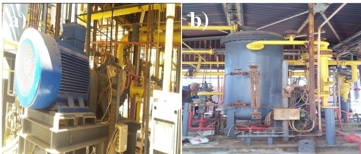
Figure II.17 :(a)Compresseur à anneau liquide, (b) Séparateur XD-161.
