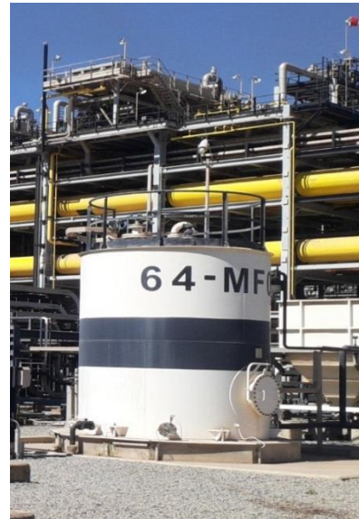
Figure II.5 : Réservoir de collecte des huiles issues du séparateur CPI.
