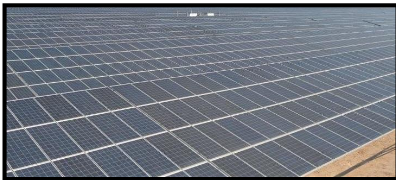
(Figure I.7 : Une centrale pilote photovoltaïque)
