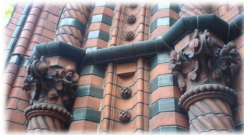
Figure 3.8 : Le rôle esthétique des matériaux dans l'œuvre architecturale, représenté par l'ornementation et la polychromie
