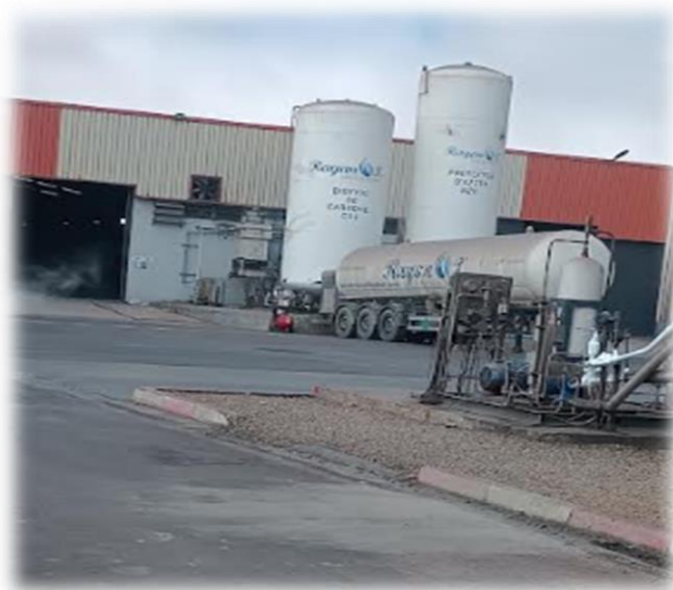
Figure I.10. Vue des réservoirs de stockage des gaz industriels au sein de Rayanox (Photo Prise sur site de Rayanox, 2026)
