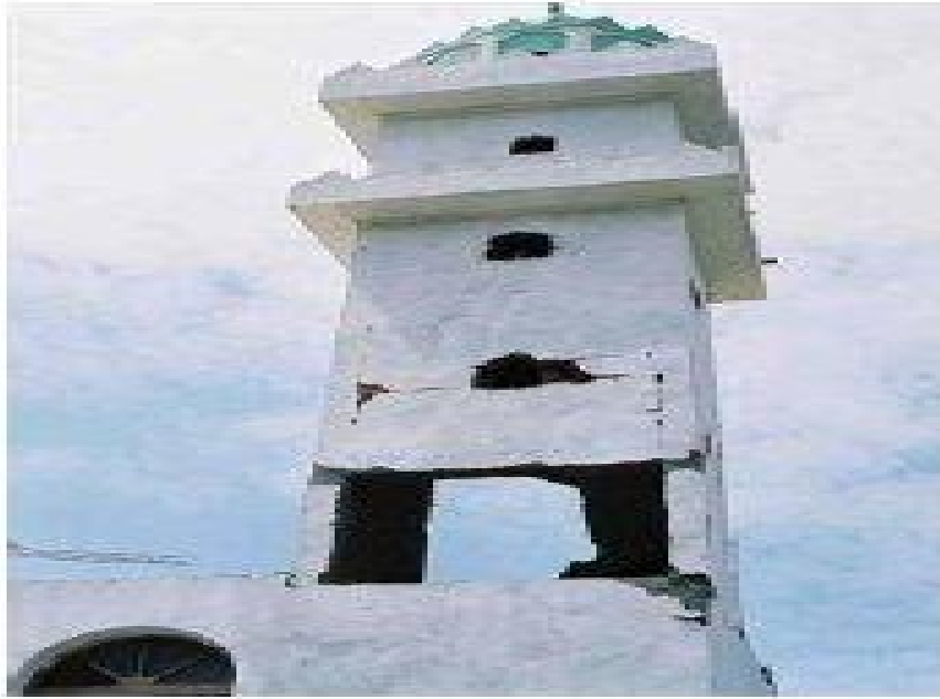
Fig. I.28 : La Mosquée de la ville de Zemmouri -minaret effondre séisme 2003 Boumerdes
