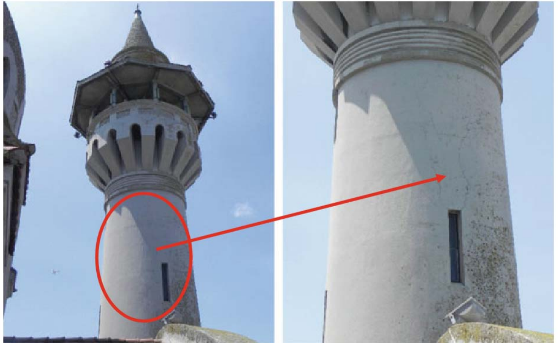
Fig .II.17 Fissures mineures dans la couche extérieure de revêtement du minaret RC de la mosquée
