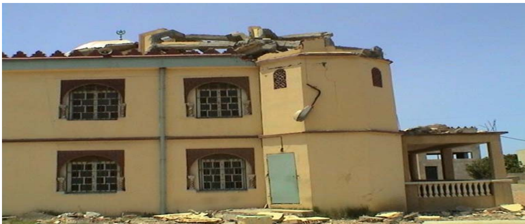
Fig. I.27 : Mosquée de Boudouaou – Minaret effondré Séisme de 2003, Bumerdes, Algérie
