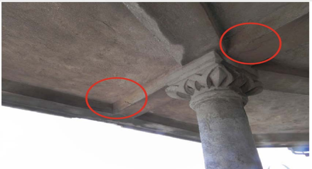
Fig .II.18 Fissures dans la couche de plâtre des poutres RC qui supportent le toit du balcon du minaret
