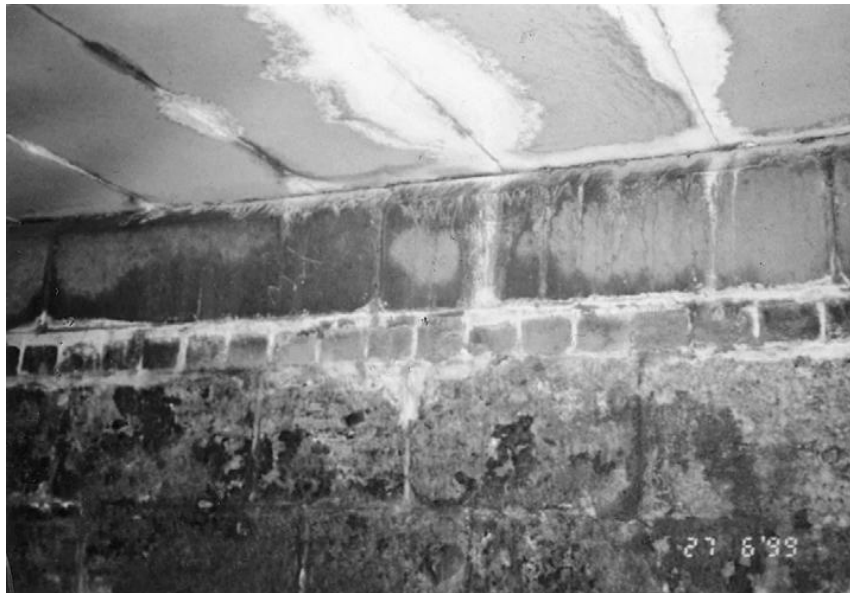
Figure I. 6. Les effets de lixiviation sur la face inférieure d'un pont jack-arc.
