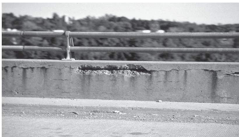
Figure I. 3. Ecaillage du béton dû à la corrosion des armatures.
