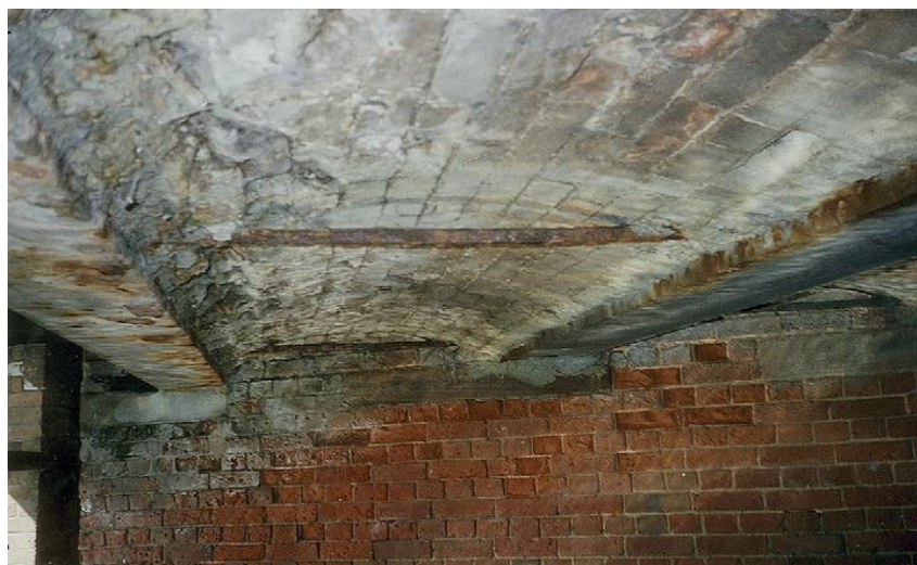
Figure I. 5. Les effets de lixiviation sur la face inférieure d'un tablier en béton.
