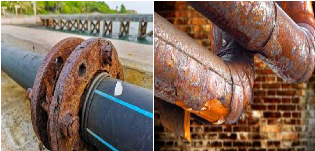
Figure 8: Corrosion des métaux
