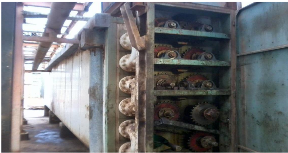
Figure III.13 : Chiller de l'unité 400.
