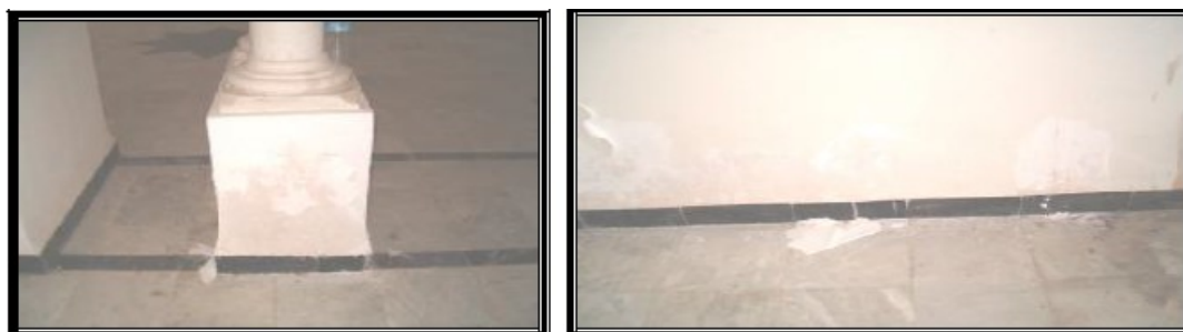
Fig. 1.18 : Passage couvert : érosion due à la condensation intermittente d'origine atmosphérique.
