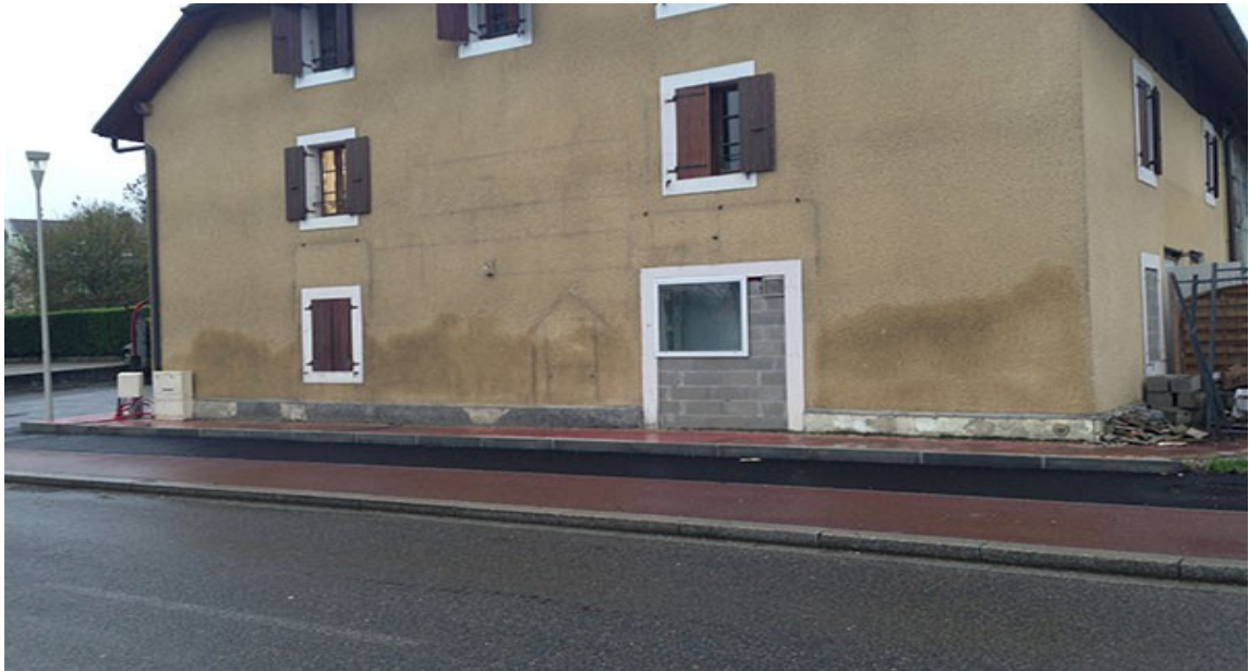
Figure 4.6 : remontée d'humidité du sol
