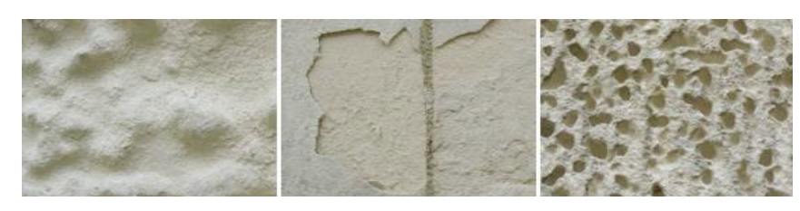
Figure 3.2. Efflorescence // desquamation // creusement d'alvéoles
