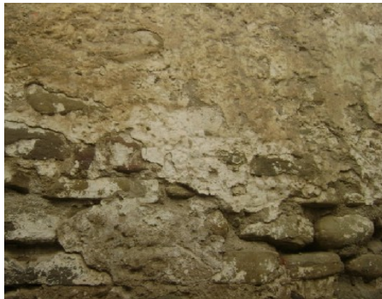
Figure 3.6 : Détérioration de l'enduit par vieillissement
