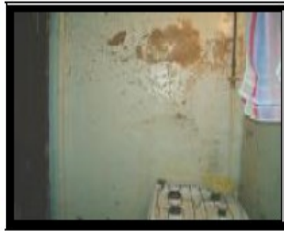
Fig.1.7 : Effet de la vapeur de cuisine
