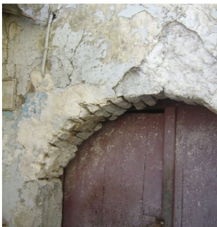
Figure 3.9 : Vieillesse et décollement d'enduit,
