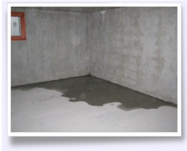
Figure 3.26 : cas d'une infiltration d'eau au sous-sol
