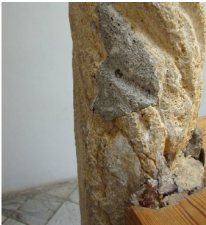
Figure 3.10 Détérioration de la colonne en tuf petite tache de coloration blanchâtre
