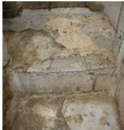
Figure 3.11 : Revêtement au sol en marbre abimé
