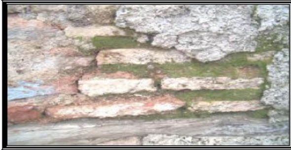
Fig.1.13 : Éclatement du mortier après gonflement
