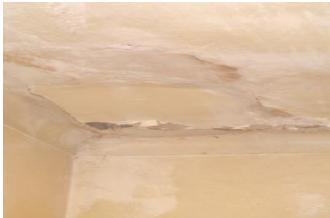
Fig.1.5 : Infiltration directe par le toit.
