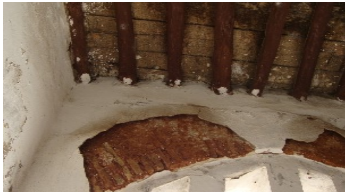
Figure. 3.8 : Gonflement, décollement en plaques d'enduit
