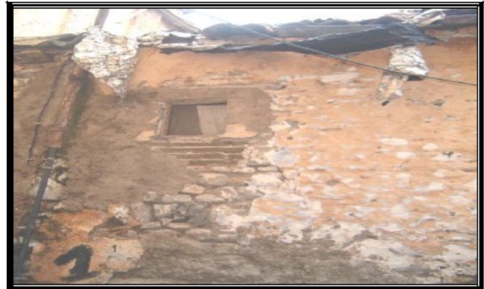
Fig.1.10 : Toiture très dégradée.
