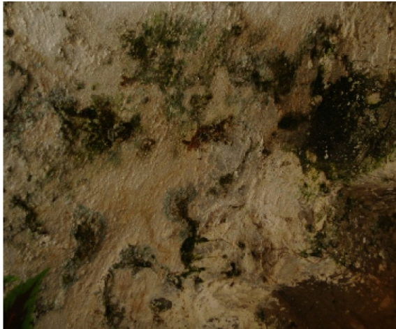
Figure 3.13: Prolifération de salissures vertes due a une humidité permanente
