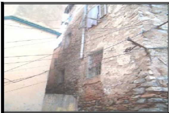
Figure. 2. 1:immeuble dégradé, quartier Suika constantine
