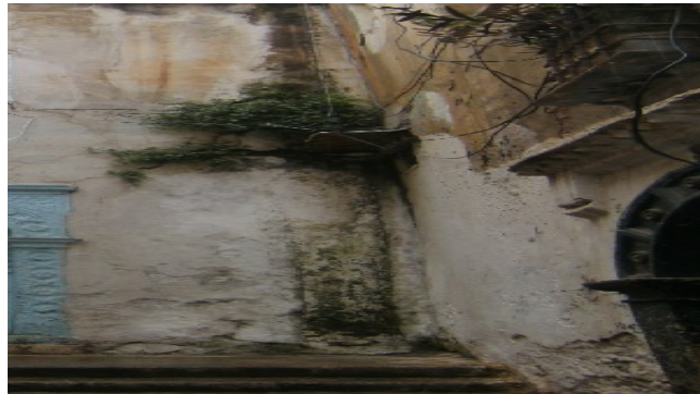
Figure 3.5 : Cloquage de l'enduit / accumulation d'humidité
