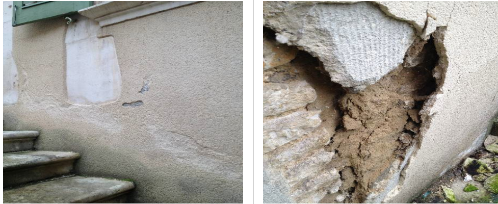
Photo 3.4. Dégradation et désolidarisation de l'enduit par le gel et l'évaporation
