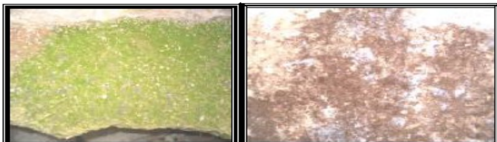
Fig. 1.12 : Moisissures sur les murs.
