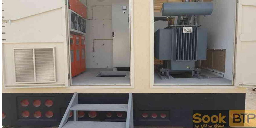
Figure II.47 : Un transformateur en cabine.
