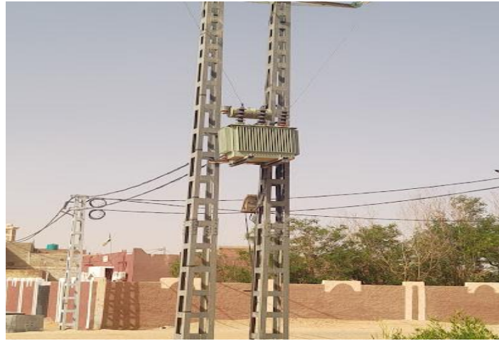
Figure II.44 : Un transformateur aérien.
