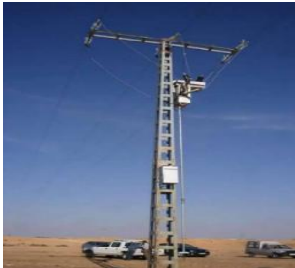
Figure II.39 : L'interrupteur aérien télécommandé à ouverture dans le creux de tension [IATCT].
