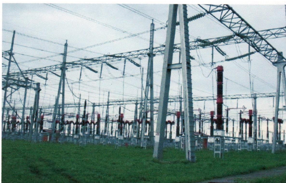
Figure I.3 : Poste électrique haute tension
