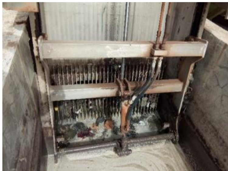
Figure II.2. dégrilleur fin mécanique. (STEP lagunage Ami moussa Relizane
