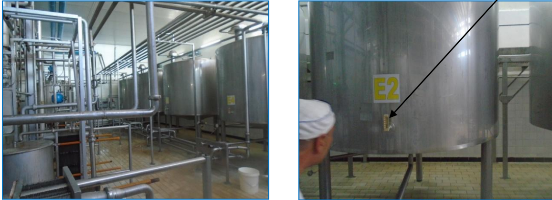
Figure n°03 : La salle de maturation ( la section fromagerie laiterie Sidi Saada)
