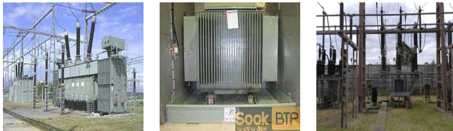
FIGURE 2.31 – Poste de transformation (© Sonelgaz)
