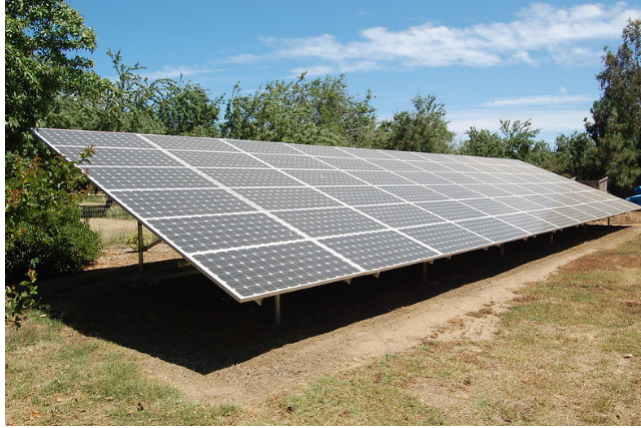
FIGURE 1.8 – Panneaux solaires photovoltaïques (©Dirvish,CCBY)
