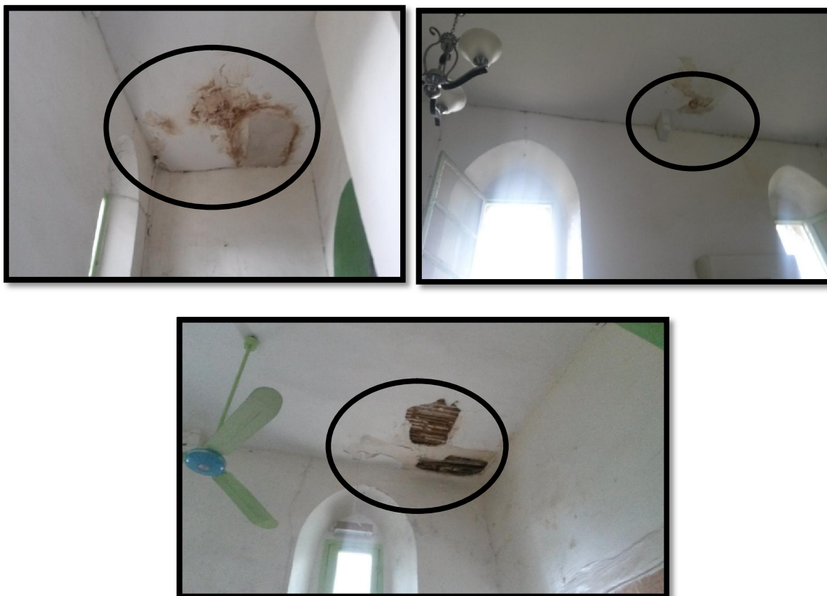
Photo démontrant les zones humides à l'intérieur au niveau de la salle de prière.
