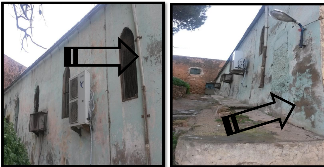
Photo sur la façade est (conduite défaillante) –source auteur du mémoire–
