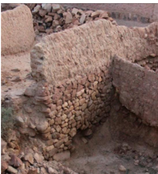
Photo 42: Photo mur de soutènement
