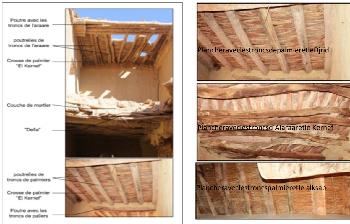
Photo 46: Les différentes composantes du plancher dans le ksar de Boussemgoun (Ait SAADI)
