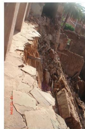
b) Site dégradé
