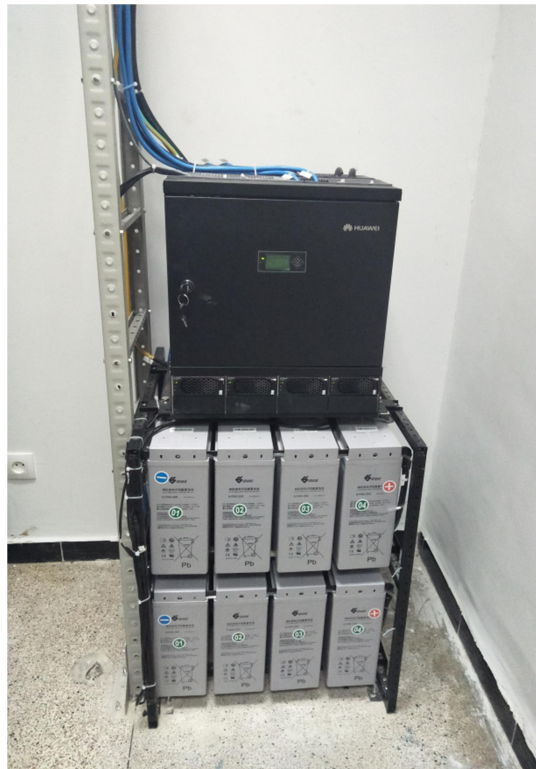
Figure 4.23 : Modules redresseurs avec ces batteries.
