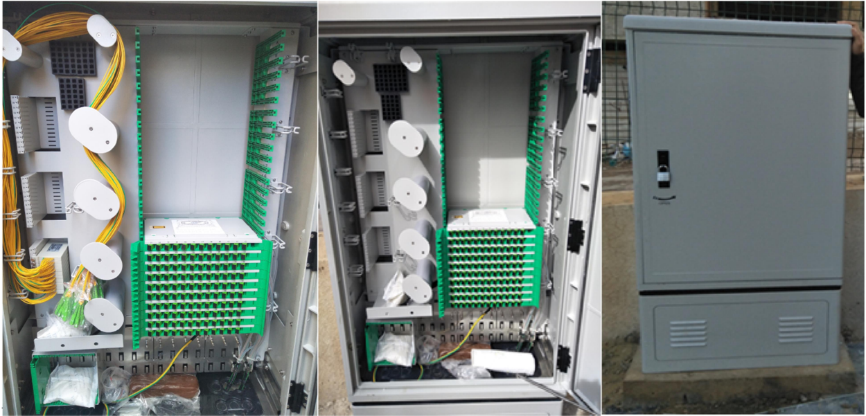
Figure 4.27 : L'FDT (Intérieur et extérieur).
