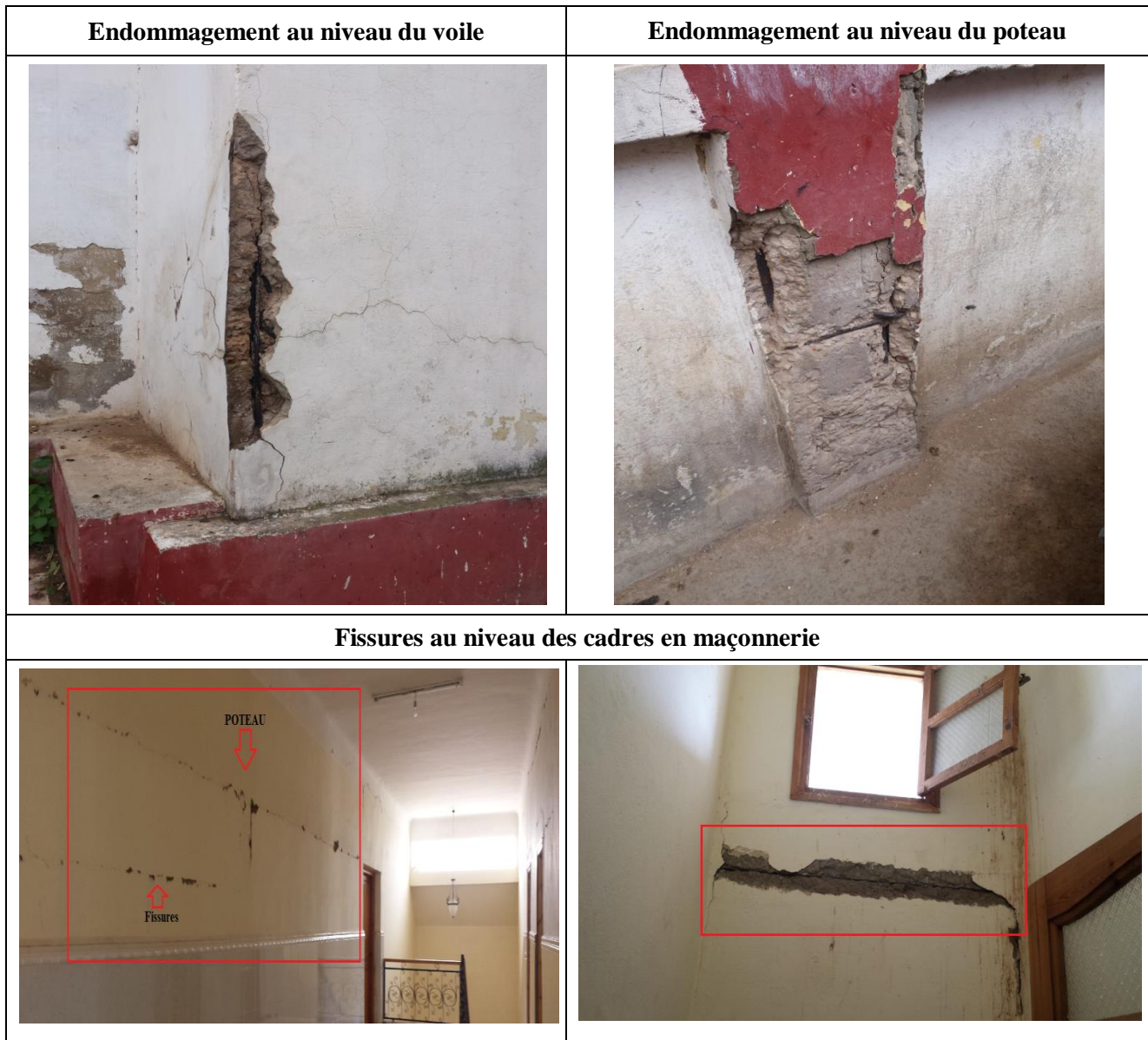
Figure 4.4 : Photos des états de dommages de la structure.
