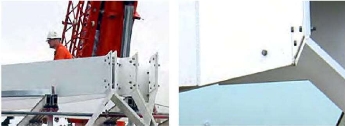
Figure 122 : Détails des joints entre la structure d'élévation périmétrique et la structure du toit
