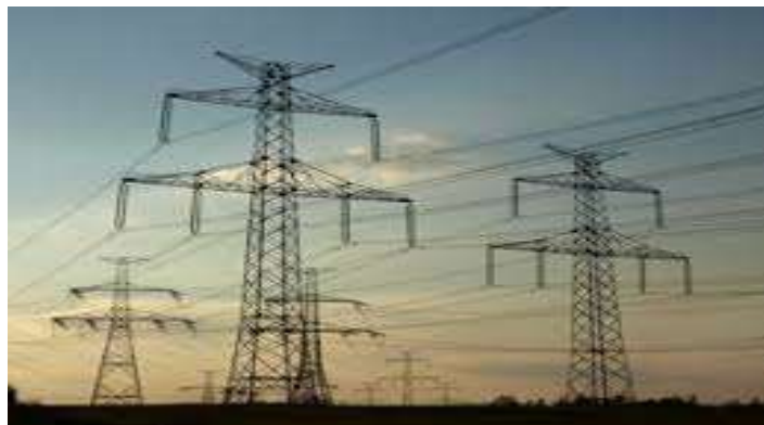
. Figure 2.2 : les lignes aériennes
