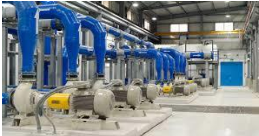
Figure II-2 : Système de pompage de l'eau de mer
