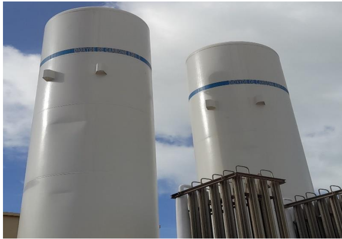
Figure II-6 : Réservoirs de stockage de CO 2
