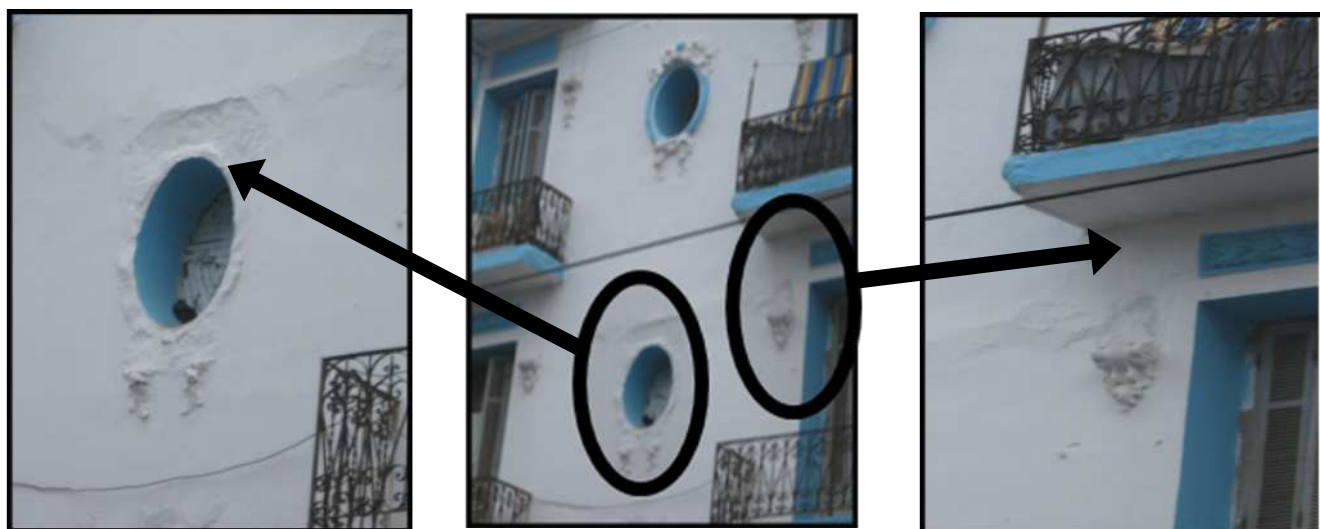
Photo.3 Ornement architectural de la façade de centre ville de Mostaganem complètement détruit.
