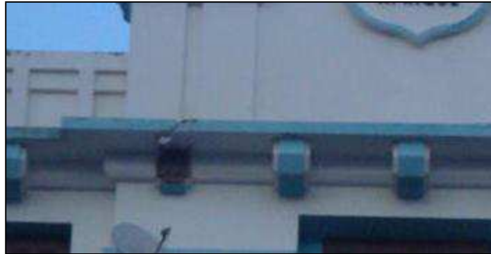
Photo 11 pathologie des ornements de la façade de BNCI
