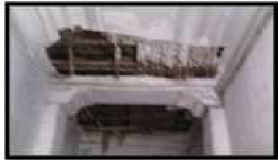
Figure. 12: l'état de dégradation des immeubles.
