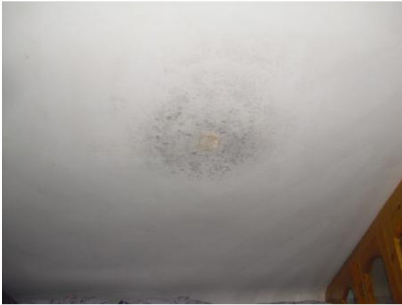
Figure IV.16: Humidité sur la toiture.
