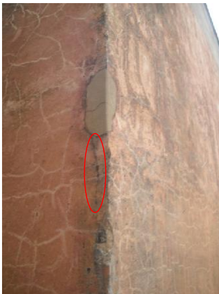
Figure IV.14: Fissures au niveau des angles.
