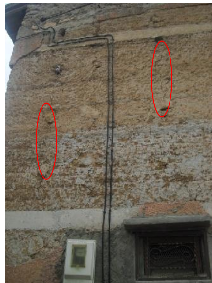
Figure IV.15: Fissures en continuité des échafaudages.
