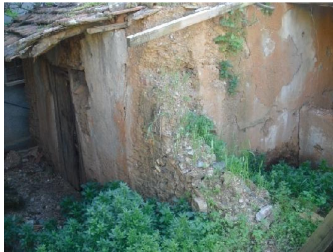
Figure III.13: Effondrement d'un mur à Ait Hmed, Mâatkas [Auteur].
