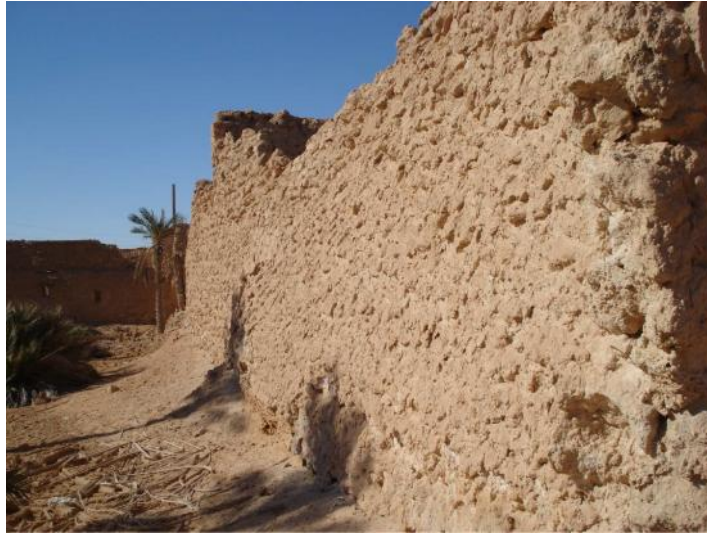
Figure III.12: Flambement d'un mur à Tamarna Lakdima [Idir, 2013].
