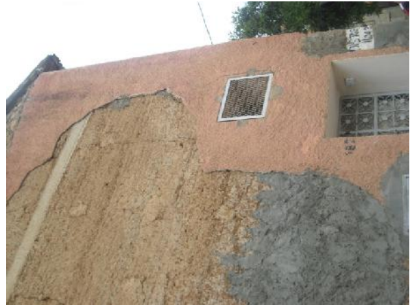
Figure IV.17: Décollement des enduits.
