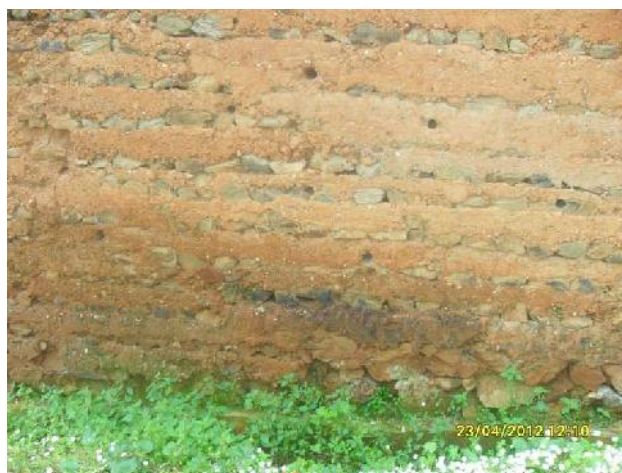
Figure III.08: Humidité par remontées capillaires, Mâatkas [Idir, 2013].
