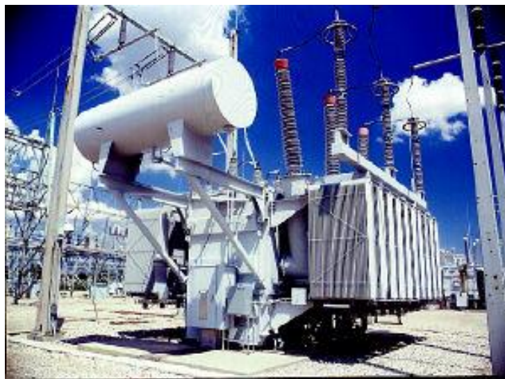
Figure I- 5 Transformateur de puissance abaisseur
