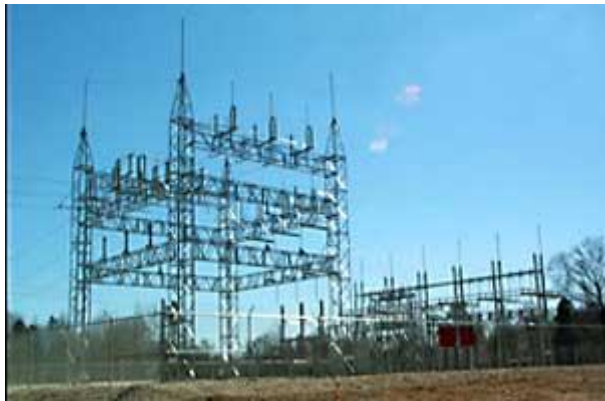
Figure I- 7 : Poste de Distribution
