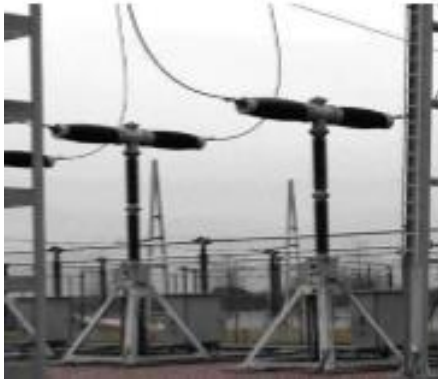
Figure II-4.1 : Deux disjoncteurs au SF6
