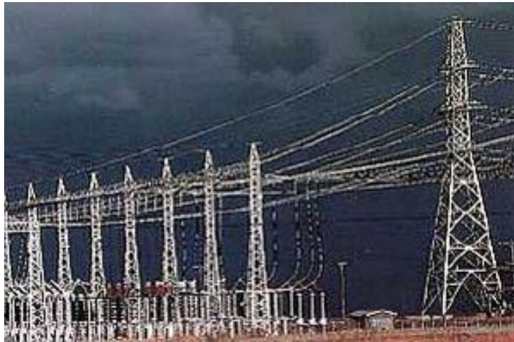
Figure I- 3 Sous-station de transport éleveur vers les lignes de transport alternatif
