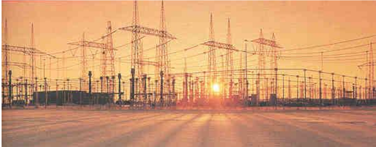
Figure I- 4 Sous-station de transmission abaisseur
