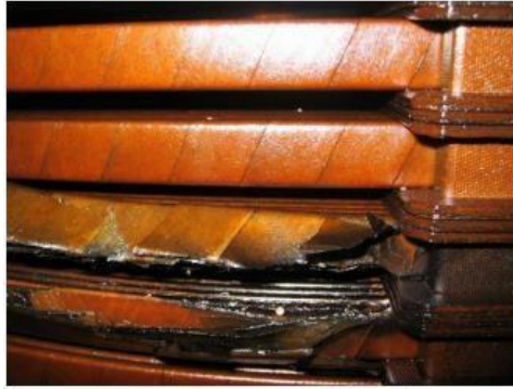
Figure I.3 : amorçage diélectrique entre spire
