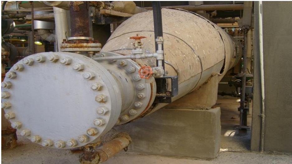
Figure IV.10 : Photo du vaporiseur 136-C
