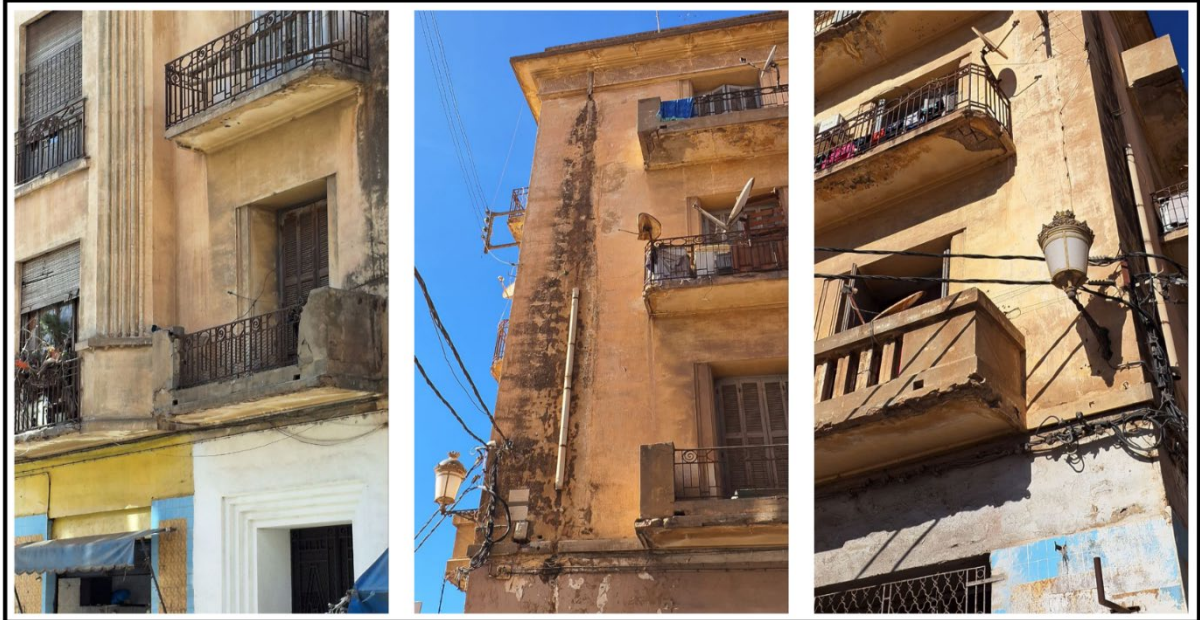
Figure 16: Pathologies des façades extérieures et balcons
