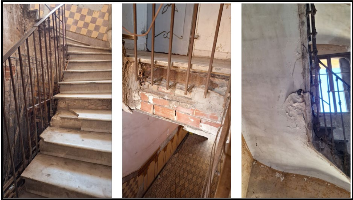
Figure 14: Détérioration des circulations verticales à l'intérieur du bâtiment
