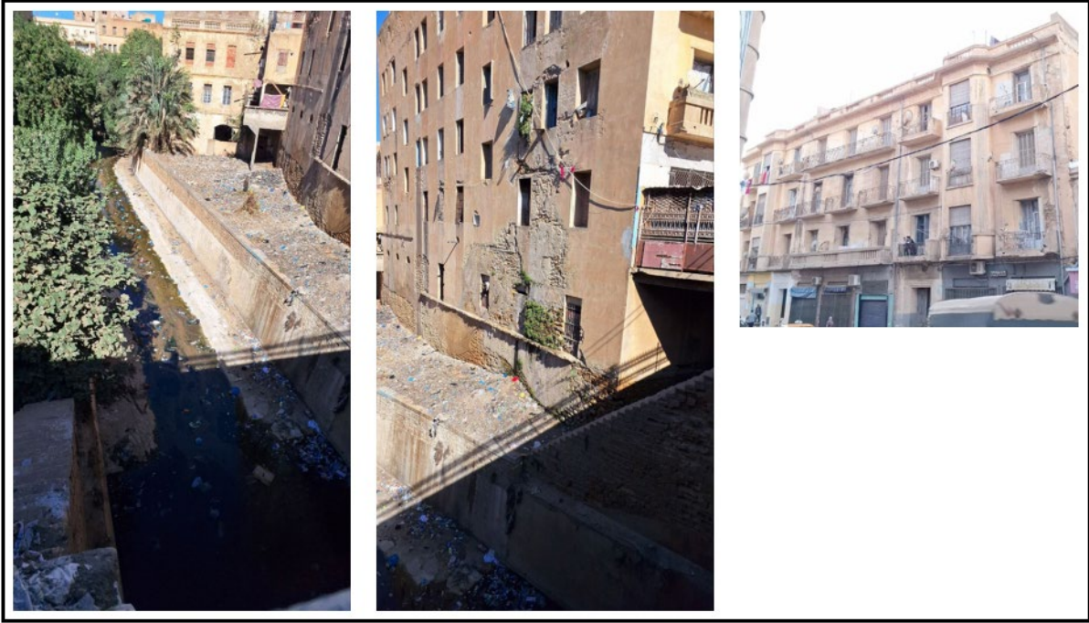
Figure 15: Dégradation de l'environnement immédiat de l'immeuble
