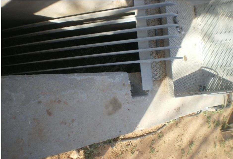
photographie I-1. Le dégrilleur de la STEP de HR
