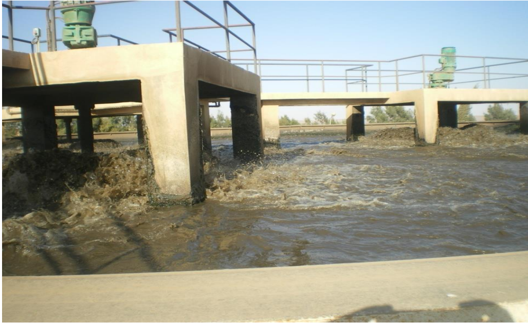
Photographie I-3. Le bassin d'aération de la STEP de HR
