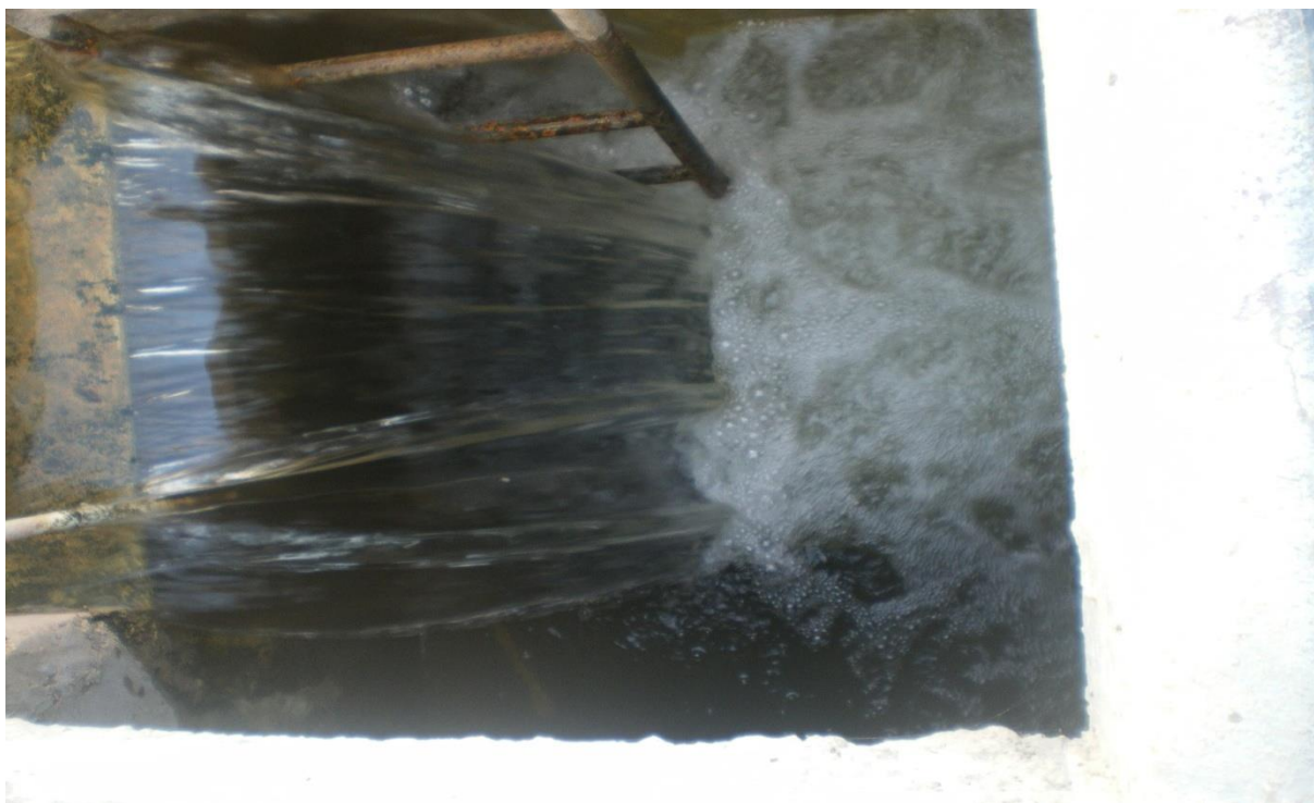
Photographie I-6. La chloration de l'eau traitée
