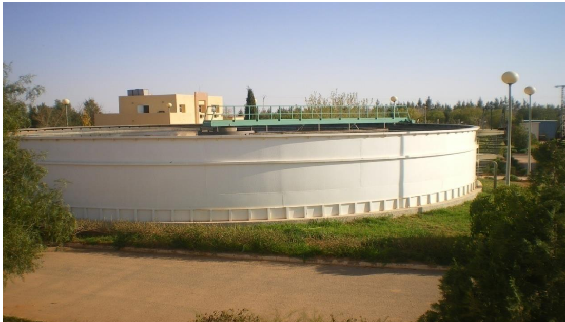
Photographie I- 4. Le bassin de clarification de la STEP de HR
