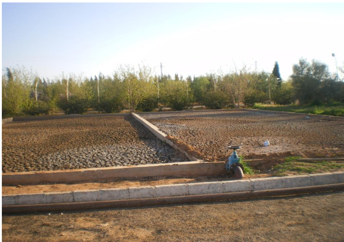
Photographie I- 8. Lit de séchage de boues dans la STEP de HR
