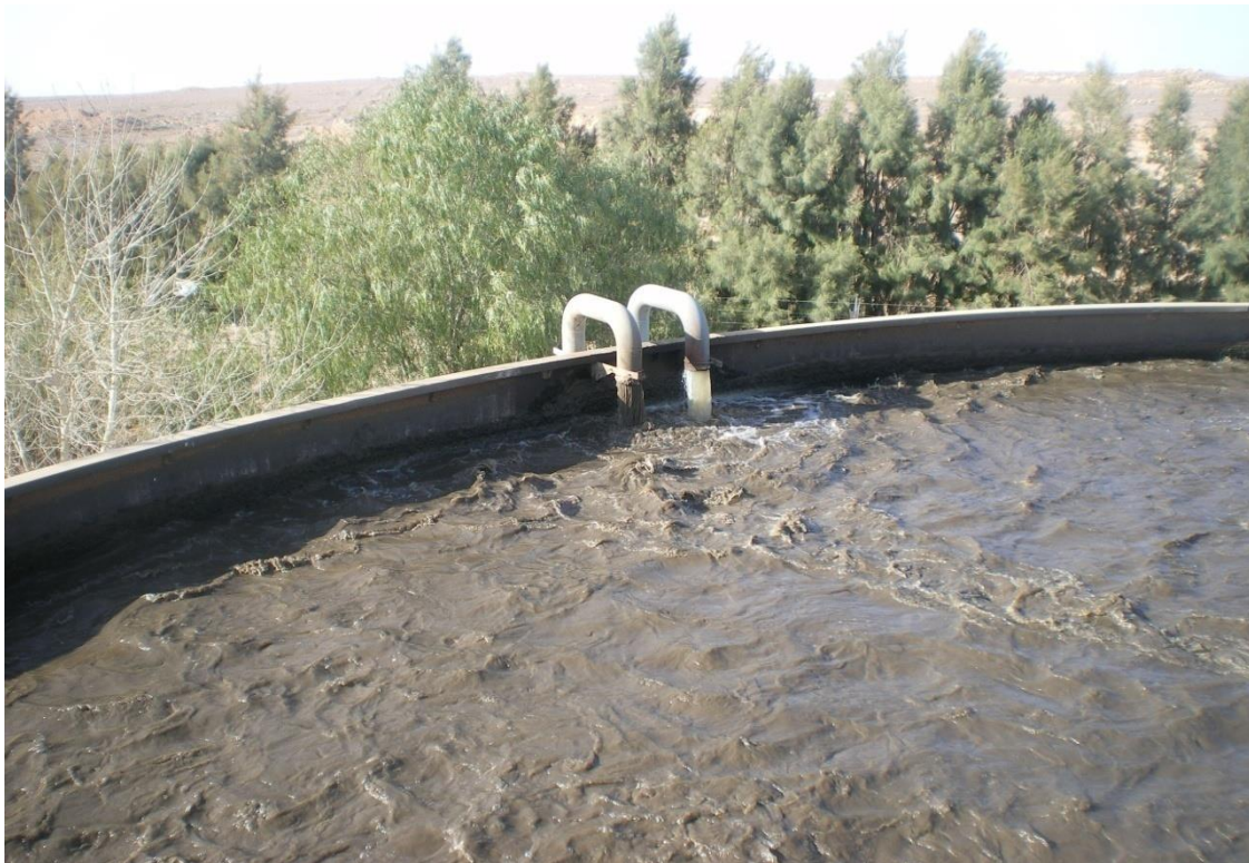
Photographie I-5. Boue recirculée au bassin d'aération de la STEP de HR
