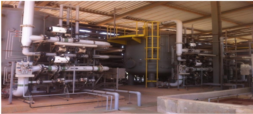
Figure I.6 : L'unité de déminéralisation et de polissage
