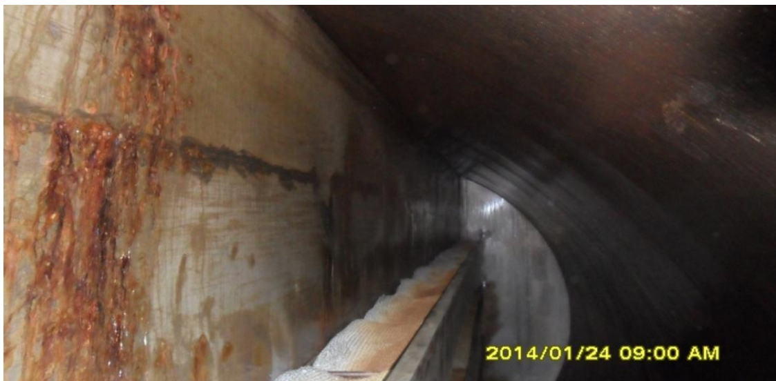
Corrosion à l'intérieur des cellules
