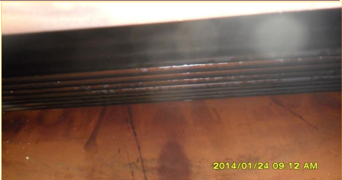
Figure II.8 Dépôt de tartre à la surface extérieure des tubes de
