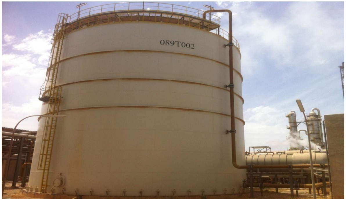
Figure I.5 : Le réservoir eau dessalée 089T002
