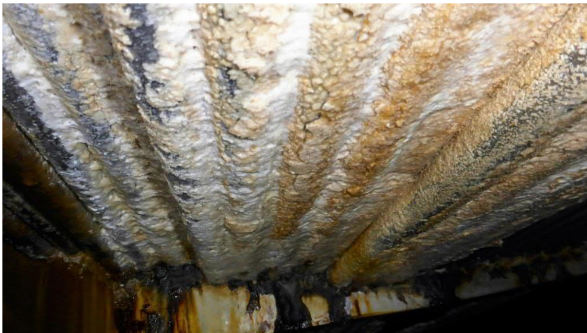
Figure 20 : Entartrage de la surface extérieure des tubes inférieurs
