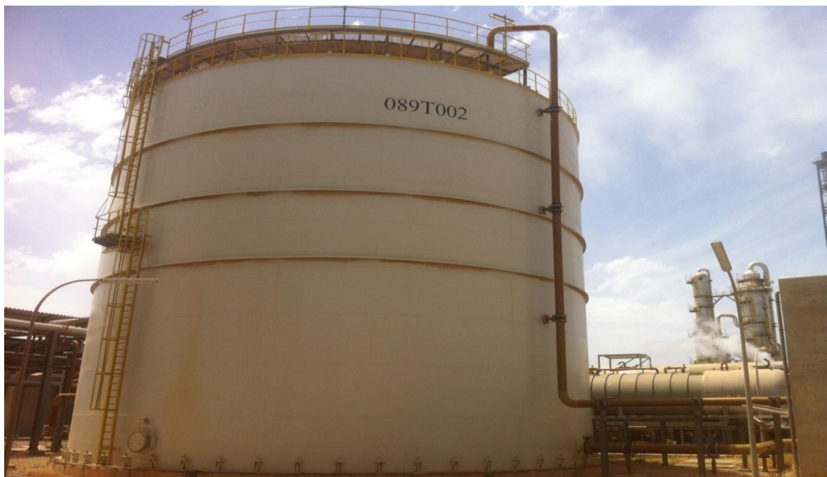
Figure 8 : Le réservoir eau dessalée 089T002
