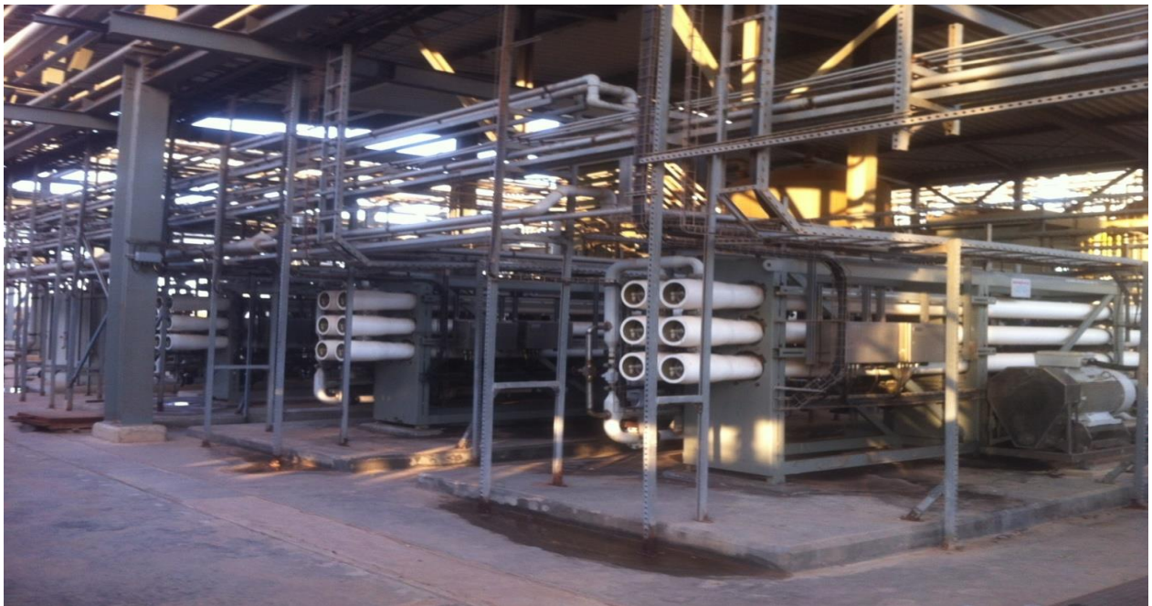
Figure 7 : L'unité du procédé de dessalement à osmose inverse
