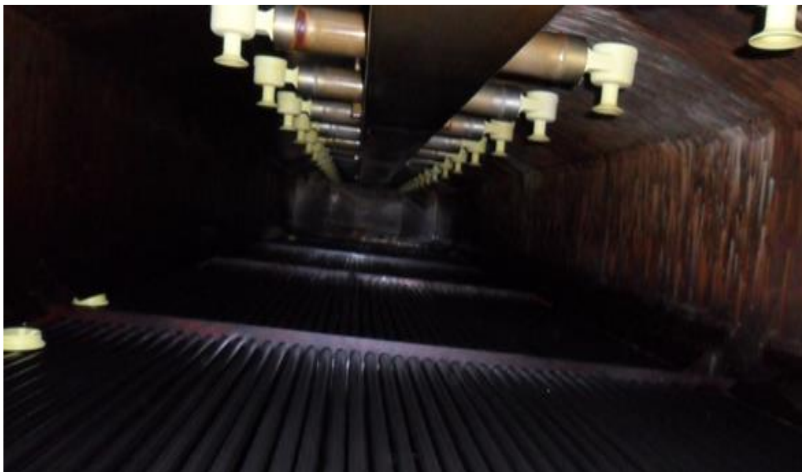
Figure 14 : La cellule d'évaporation de l'unité de dessalement U .510
