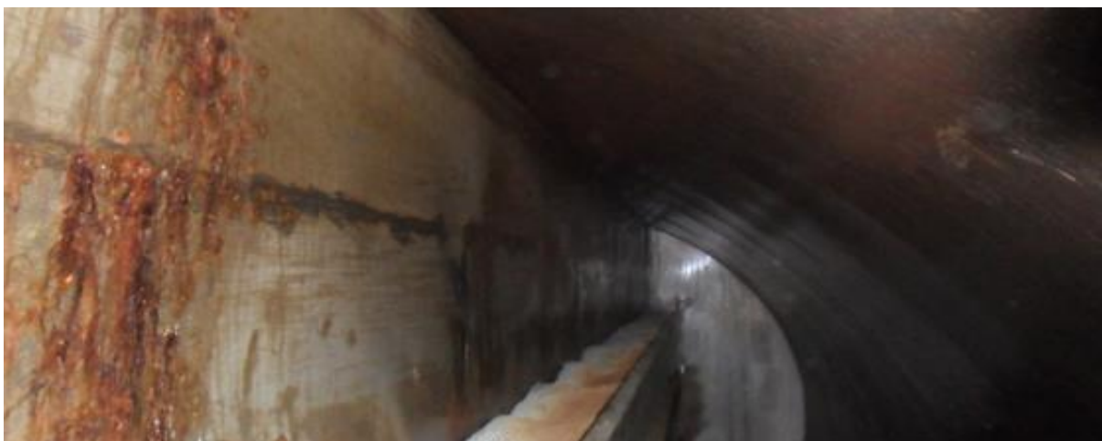
Figure 19 : Corrosion des parois à l'intérieur des cellules 1
