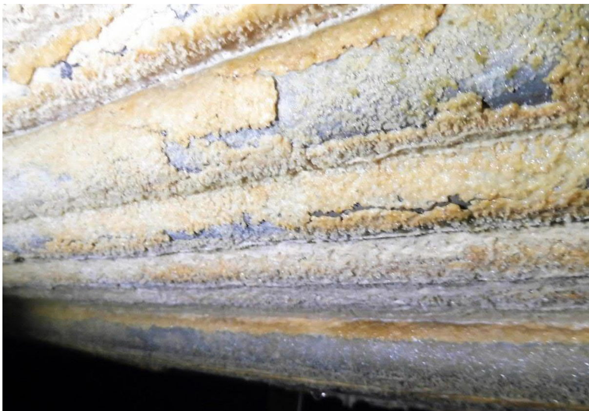
Figure 21 : Dépôt de tartre à la surface extérieure des tubes de l'évaporateur
