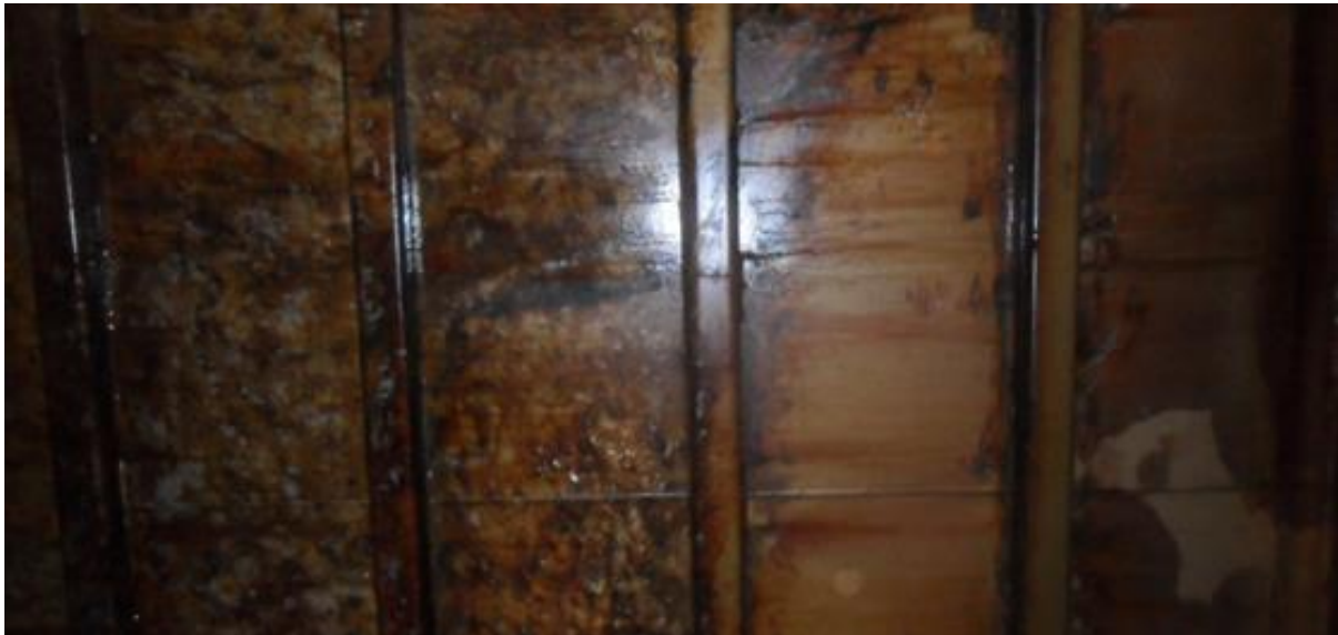
Figure 18 : Corrosion des parois
