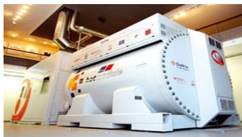
Figure I.18 Exemple Pile MCFC 250 kW baptisée CELLIA et mise en place par Dalkia dans un HLM à Paris.
