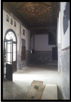
Figure 217 plafond en plâtre
