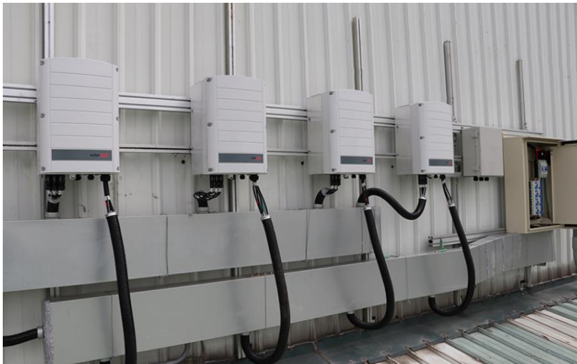
Figure I.23 : Onduleur de système énergie solaire
