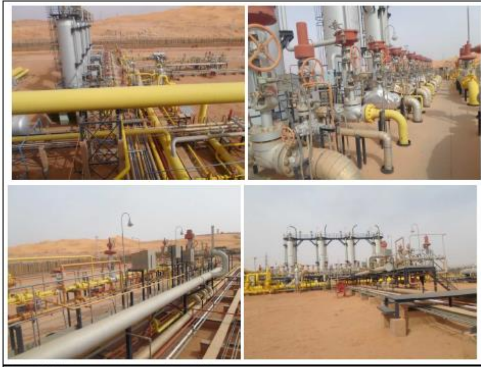
Figure 8 Unité de déshydratation de gaz
