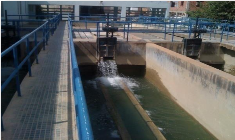
Figure N°4 : le bassin de filtration.
