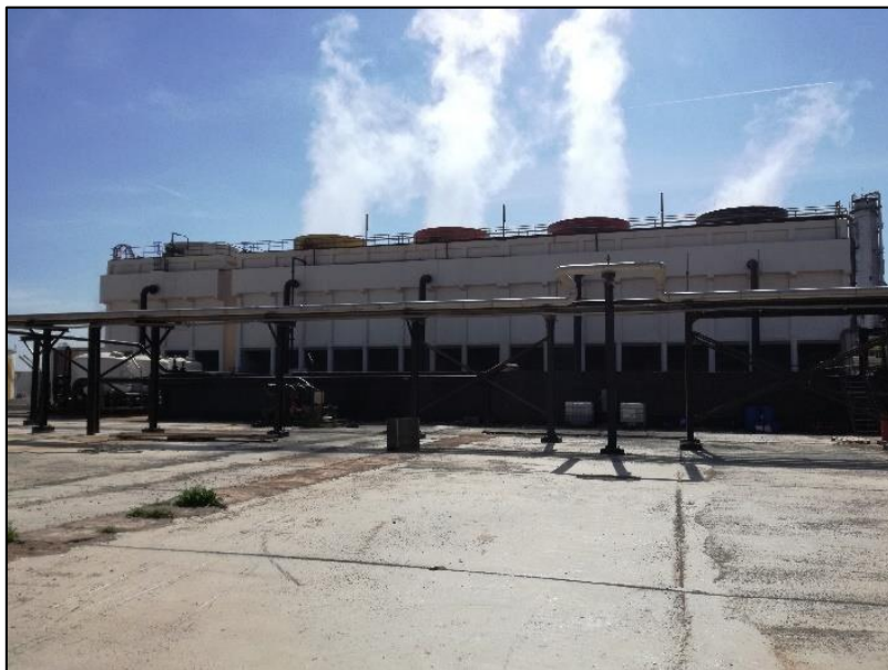
Figure I.5 : Tour de refroidissement 33E101.
